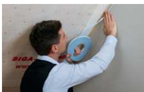
Frein-vapeur sur mur de construction massive
