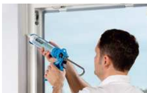
Verbindingsvoegen van ramen, deuren en gevels, lekken en doorvoeren
